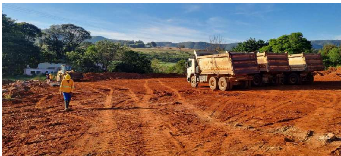
Foto 11 – Demolição, retirada dos entulhos dentro da área de plantio e direcionamento do material caminho de serviço. (Foto: 04/05/2023)
